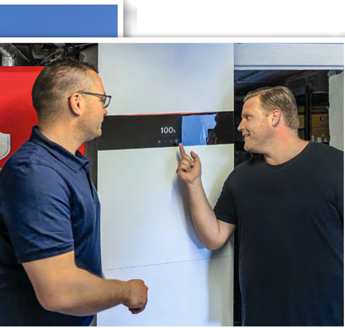
Voll geladen: Ein Speicher im Keller puffert den Solarstrom.
